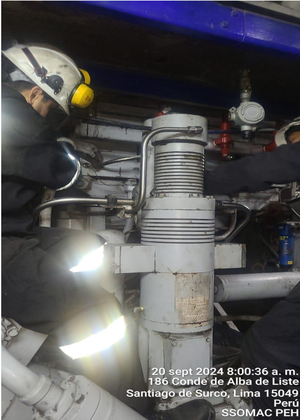
Figura 6: Mantenimiento de motores de compresore
