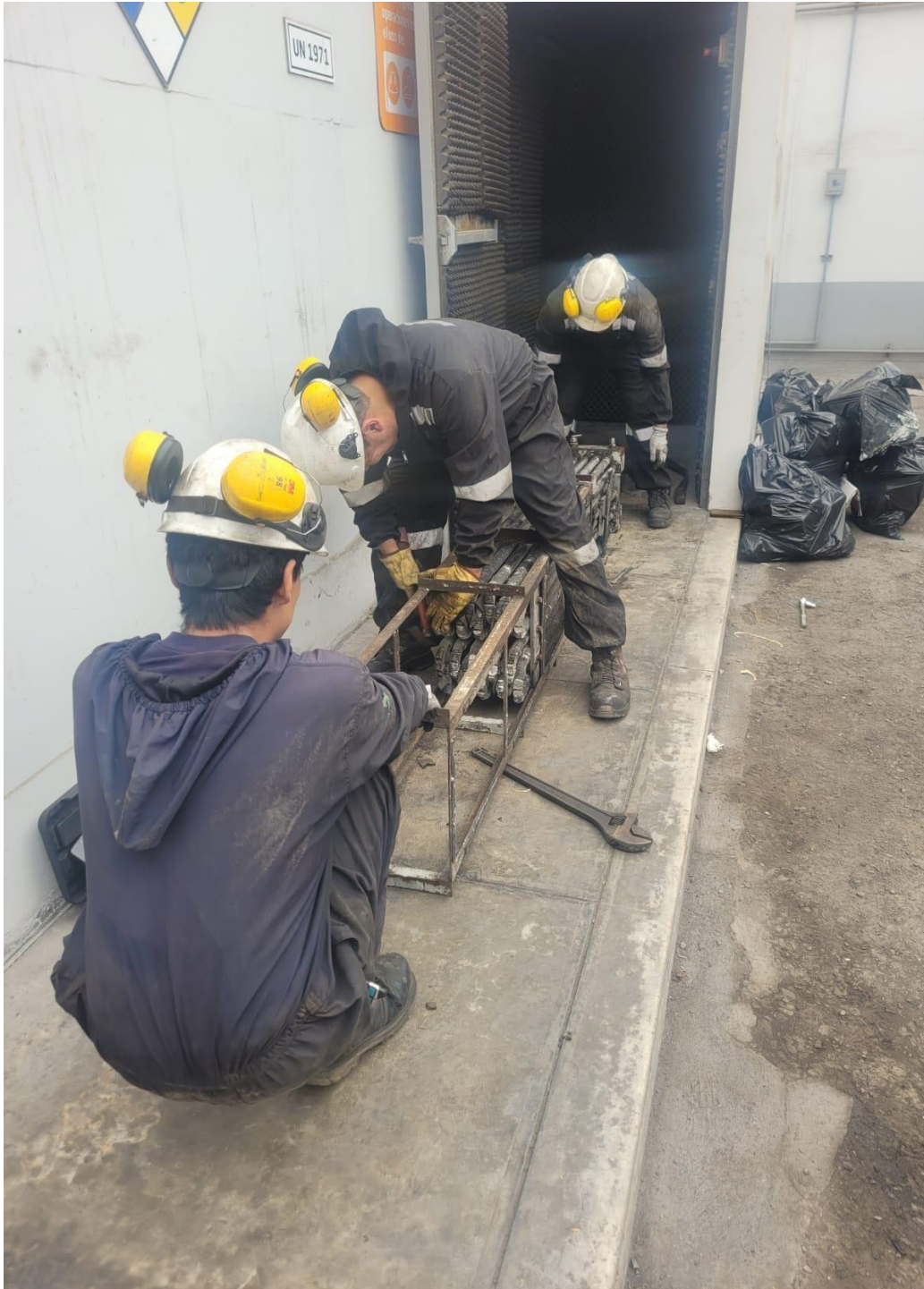
Figura 5: Mantenimiento general de compresores
