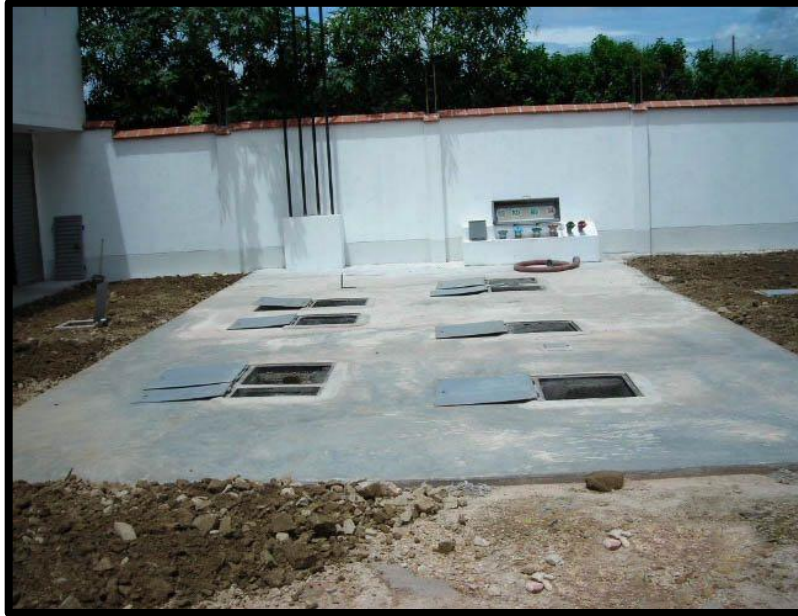
Figura 7. Tanques Enterrados Bajo Superficie
