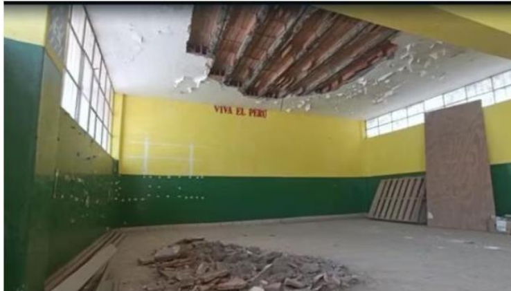
Figura 37: Alerta de colegio en Arequipa en malas condiciones.
