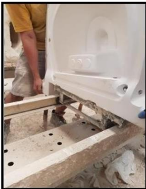
Momento donde los operarios encajan de forma adecuada los moldes en los rieles de los moldes de la línea de moldes.
