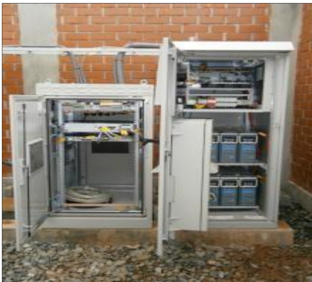
Figura 25: Shelter Eltek del Nodo Terminal
