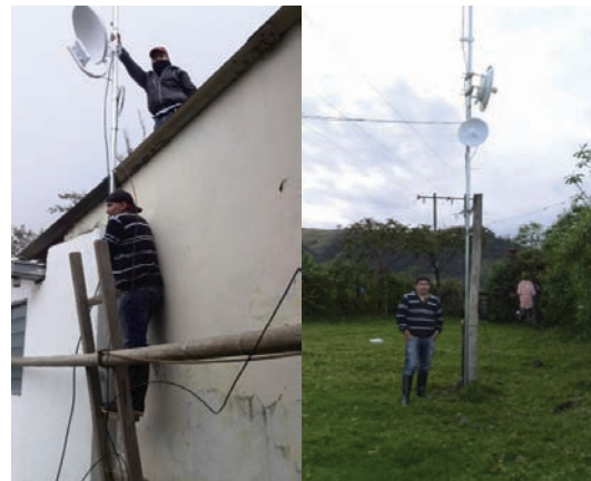
Figura 6: Instalación en Cuaré y repetidor.
