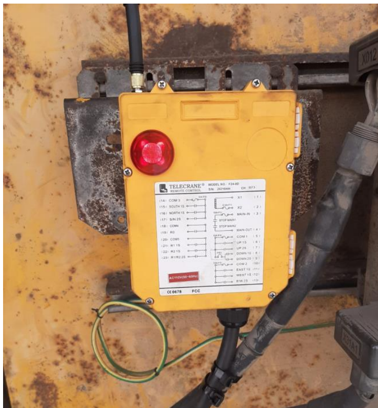
Figura 36: Instalación de receptor del equipo Fuente: Elaboración propia
