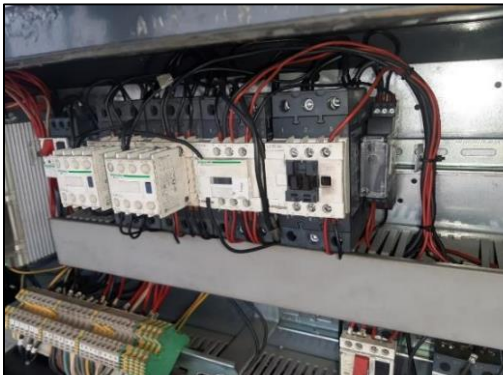
Figura 44: Nuevo conexionado con temporizadores on y off delay Fuente: Elaboración propia
