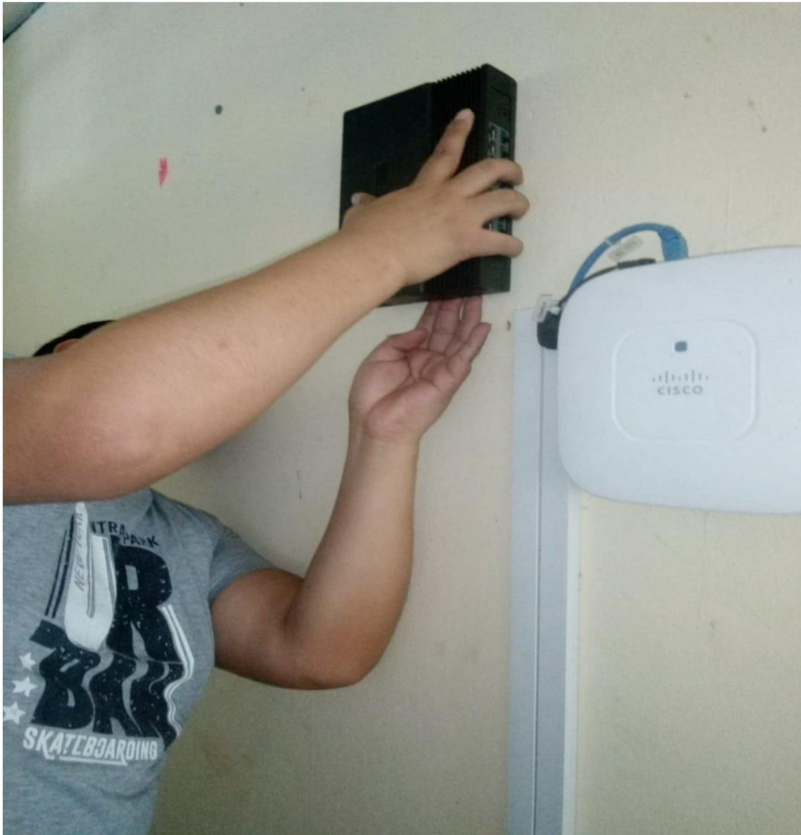
Instalación del switch 16 puertos
