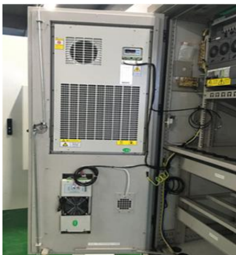
Figura 5.34 Equipó de Aire Acondicionado en gabinete de energía (Fuente; Fabricante Sanda)
